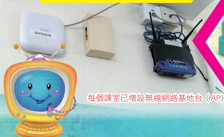
優化電腦室設備
